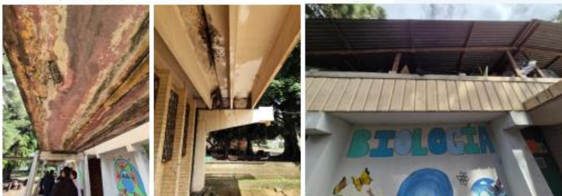
Imagen 14 y 15. Filtraciones de agua en losa. Foto 16. Cubierta de lámina sobre losa para evitar filtraciones al interior, Fuente: CGP
