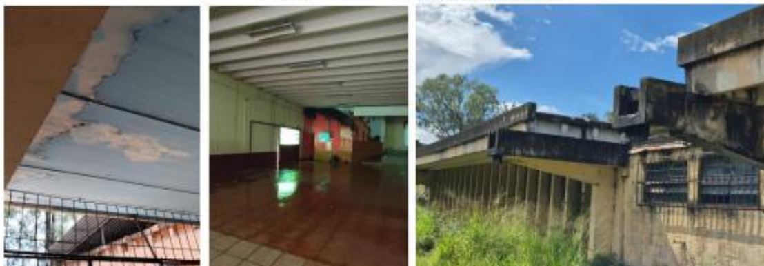
Imagen 17. Desprendimiento de pintura por humedad en losa interior. Imagen 18. Filtración de agua pluvial al interior del salón. Imagen 19. Hongos y líquenes en superficies de cenefas. Fuente: CGP
