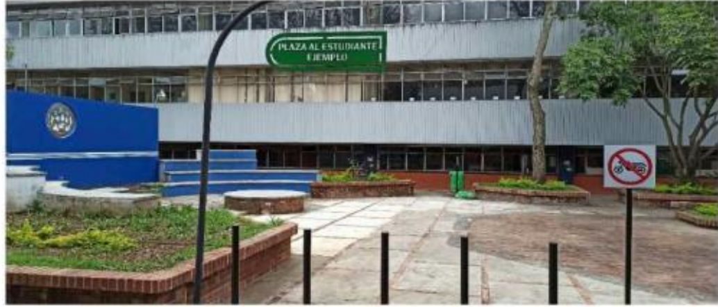
Fotografía. Estado del muro de Plaza del Estudiante Ejemplo- agosto 2020.
