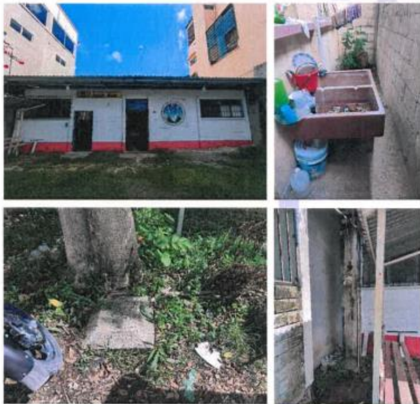
Foto 18, 19, 20 y 21. Iluminación exterior, pila, caja de drenajes y contador electricidad Fuente: CGP
