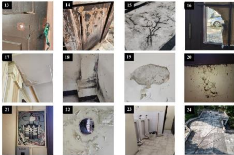
13 Puerto en fuga, Medicina. 14 Puerto con desprendimiento de barro, Medicina. 15 Puerto con grietas, Medicina. 16 Vitrina en BPO, Tiquis. 17 Ficho con filtración de agua, BPO. 18 Columna con filtración de agua, Medicina. 19 Ficho con desprendimiento de yeso, Medicina. 20 Ventana con presencia de termita y humedad, edificio central. 21 Caja de distribución eléctrica con presencia, Medicina. 22 Ficho con filtración de agua por acueducto de otro, Medicina. 23 Piso de servicios sanitarios con presencia de merla de agua, Medicina, en baños, Medicina.
