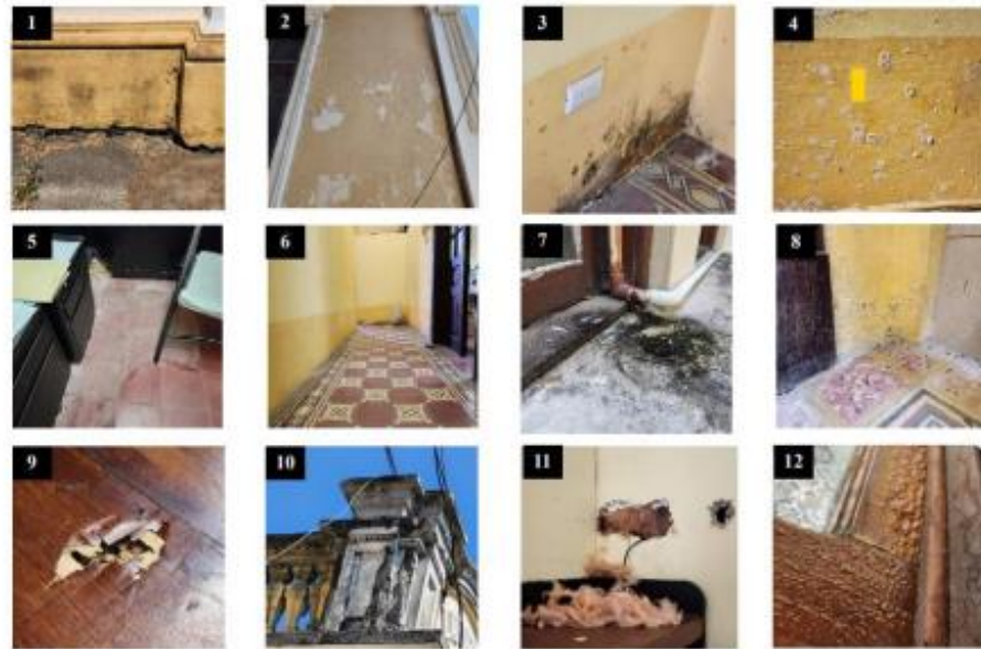
1) Corrimón con daño en USAC. 2) Muro con deterioramiento de pintura. 3) Muro con presencia de humedad. 4) Muro con presencia de humedad. 5) Piso con pintura de humedad. 6) Piso con pintura de humedad. 7) Tubería con fuga de agua. 8) Muro con humedad. 9) Muro con pintura de agua. 10) Muro con pintura de agua. 11) Muro con pintura de agua. 12) Muro con pintura de agua.
