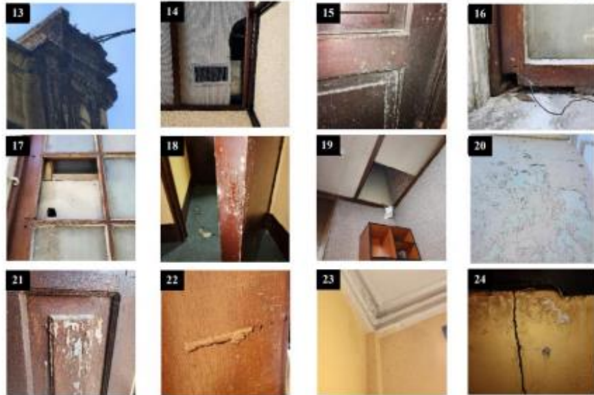
13) Fachada con daño en resaca con agua. 14) Fachada con daño. 15) Puerta con pintura de humedad. 16) Fachada con daño. 17) Fachada con daño. 18) Fachada con daño. 19) Fachada con daño. 20) Fachada con daño. 21) Fachada con daño. 22) Fachada con daño. 23) Fachada con daño. 24) Fachada con daño.
