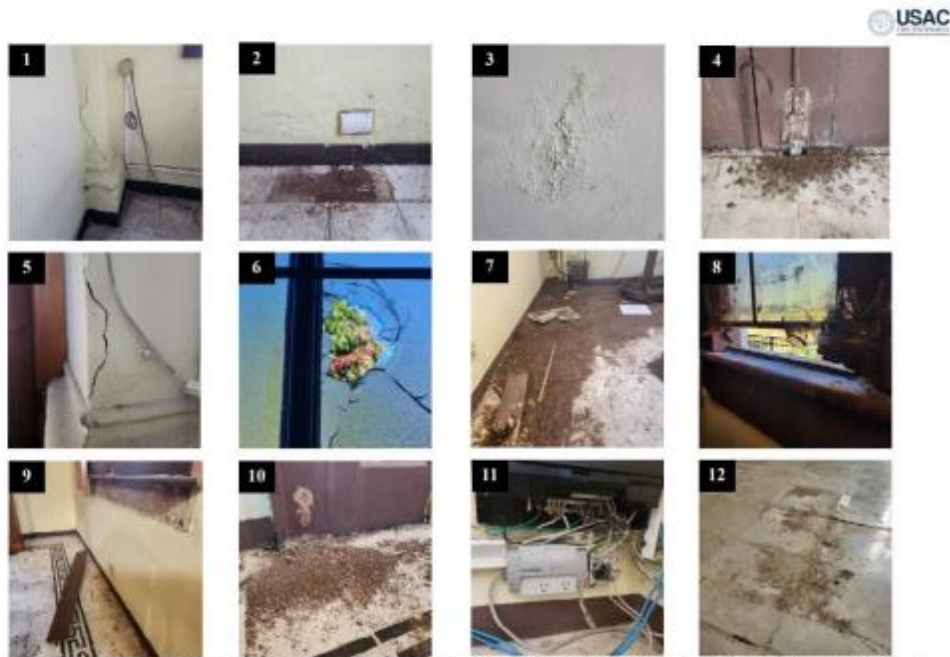
1) Columna con flechas en reparación. Unidad de Radiación. 2) Piso con presencia de líquido de refrigeración, helado. 3) Muro con filtración de agua. Medicina. 4) Fuente con presencia del líquido de refrigeración. Medicina. 5) Columna con flechas y deterioramiento del revestimiento. Educación superior. 6) Ventana con vidrio. Sello de seguridad. 7) Piso con presencia de líquido de refrigeración. Educación. 8) Ventana con deterioro en marco de madera. Educación. 9) Muro de cemento con abaqueamiento. Educación. 10) Piso con presencia del líquido de refrigeración. Educación. 11) Caja de distribución eléctrica con cables sueltos, tendidos. 12) Piso con manchas de agua. Medicina.
