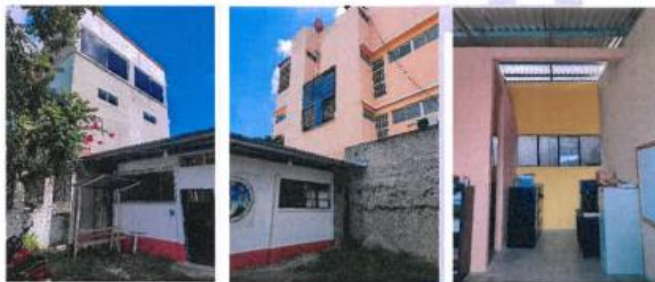
Foto 15, 16 y 17. Ventanas en el muro de la fachada principal y posterior del inmueble Fuente: CGP
