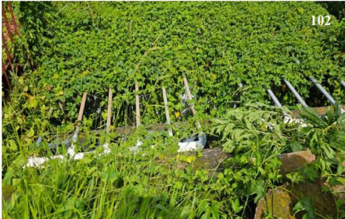
Fotografía 102 , Segunda batería de filtros. Nótese el crecimiento de la maleza sobre los lechos filtrantes y que será necesario podar para dejar libres a los lechos filtrantes en mención. En similares circunstancias se encuentra la tercera batería de filtros.
