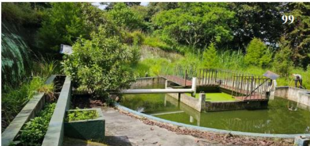
Fotografía 99 , que muestra el estado actual del canal de entrada del caudal de agua servida a tratar, así como el sedimentador. Nótese la maleza y la arena que tiene azolvado el canal. Así también nótese las condiciones de la estructura y el estado actual del sedimentador.
