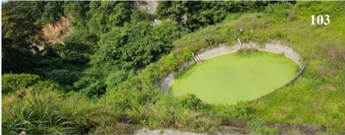
Fotografía 103, Muestra el Digestor de lodos y al fondo el área de patios de secado de lodos. Nótese la presencia de la cantidad de maleza existente en el área y que, en el caso de los patios de secado, no se ven porque dicha maleza los ha cubierto por su tamaño y extensión tan grandes. Toda el área mostrada requiere de chapeo y limpia a profundidad, más el mantenimiento que debe de darse al digestor para que funcione en óptimas condiciones.
