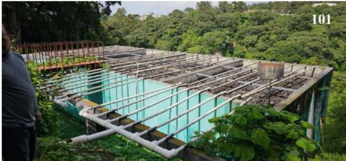
Fotografía 101 , Vista de la primera batería de filtros que muestra el estado de las tuberías de entrada del caudal a los mismos y que será necesario cambiar y colocarle llaves de paso para control de dicho caudal. Esto se deberá de hacer en las tres baterías de filtros.
