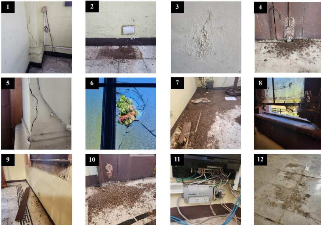
1) Columnas con fisuras en repello, Unidad de Evaluación. 2) Piso con presencia de tronera de zompopos, Medicina. 3) Muro con filtración de agua, Medicina. 4) Puerta con presencia de tronera de zompopo, Medicina. 5) Columna con fisura y desprendimiento de repello, Educación continua. 6) Ventana sin vidrio, Salón de reuniones. 7) Piso con presencia de tronera de zompopo, Dirección. 8) Ventana con deterioro en marco de madera, Dirección. 9) Marco de ventana con desprendimiento, Dirección. 10) Piso con presencia de tronera de zompopo, dirección. 11) Caja de distribución telefónica con cables cortados, Secretaría. 12) Piso con manchas de agua, Medicina.
