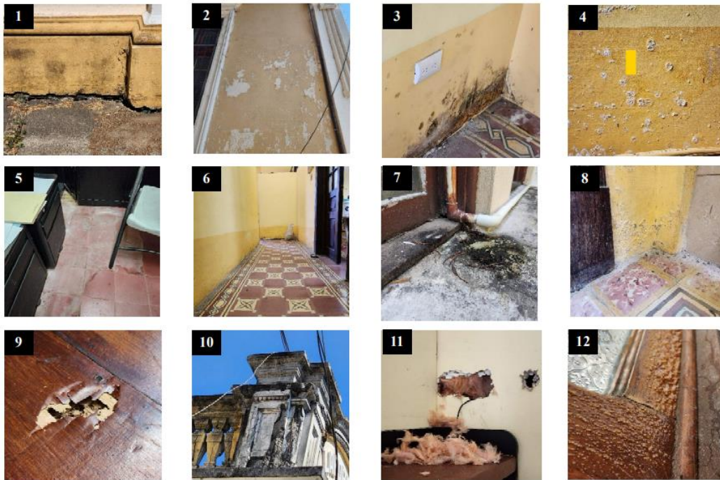
1) Columna con daño en base, ESA. 2) Muro con desprendimiento de pintura, ESA. 3) Muros con presencia de humedad, ESA. 4) Muros con presencia de humedad, ESA. 5) Piso con huella de humedad, ESA. 6) Piso con hundimiento, ESA. 7) Tubería con fuga de agua, ESA. 8) Muro con humedad, ESA. 9) Duela dañada por polilla, ESA. 10) Fachada con daño en repello, Radio USAC. 11) Tablayeso dañado, Radio USAC. 12) Ventana con barniz deteriorado.
