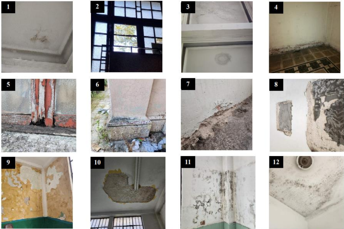
1) Techo con filtración de humedad, Odontología. 2) Ventana con vidrio quebrado, Odontología. 3) Techo con filtración de agua, Odontología. 4) Muro con deterioro en base por humedad, Odontología. 5) Ventana con marco dañado, Odontología. 6) Columna con grizas sobre repello, Odontología. 7) Muro con deterioro en base por humedad, Odontología. 8) Muro con perforaciones de cajas, Odontología. 9) Muro con desprendimiento de pintura, Odontología. 10) Techo con desprendimiento de repello, Odontología. 11) Muro con moho y filtración de humedad, Odontología. 12) Techo con filtración de humedad, Odontología.
