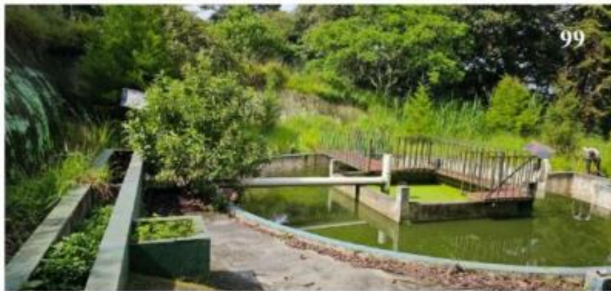
Fotografía 99 , que muestra el estado actual del canal de entrada del caudal de agua servida a tratar, así como el sedimentador. Nótese la maleza y la arena que tiene azolvado el canal. Así también nótese las condiciones de la estructura y el estado actual del sedimentador.
