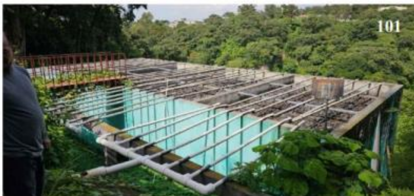
Fotografía 101 , Vista de la primera batería de filtros que muestra el estado de las tuberías de entrada del caudal a los mismos y que será necesario cambiar y colocarle llaves de paso para control de dicho caudal. Esto se deberá de hacer en las tres baterías de filtros.
